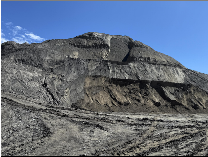
照片 3-1 现状不稳定斜坡
